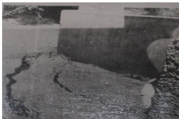
Рис. 3. Выпор грунта из-под подошвы фундамента.
