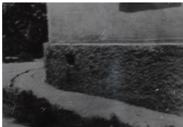
Рис. 2. Деформация переувлажнённых насыпных грунтов вокруг дома.
